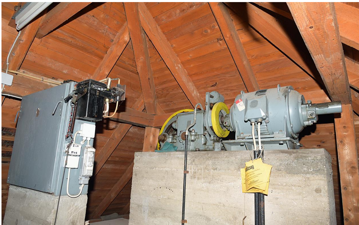
Abb. 2: Blick in den Dachstuhl des Aufzugturmes im Maba-Gebäude mit dem hauptsächlich Fundort von Fledermauskot durch Gfrörer-Ingenieure (2022).
